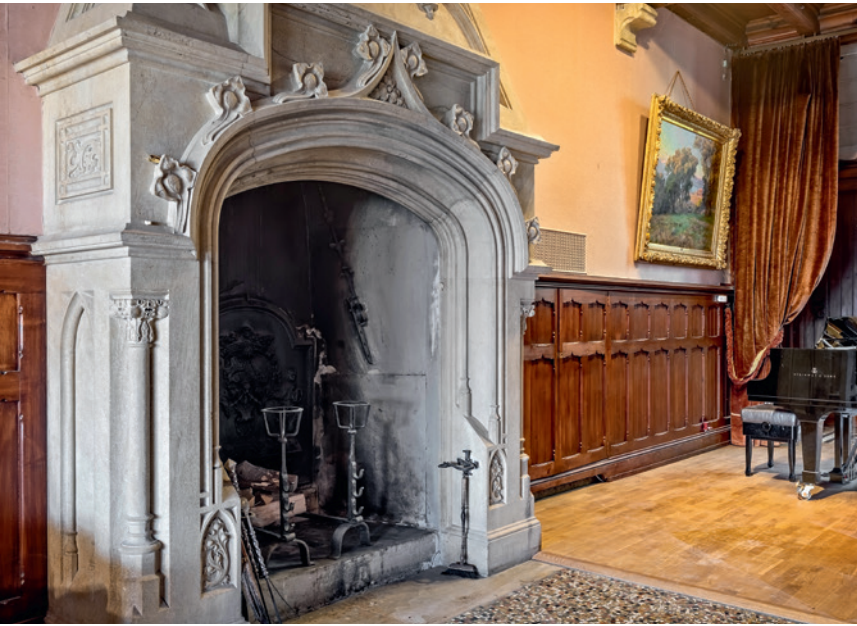
Au centre de la grande salle se dresse une impressionnante cheminée en pierre de taille sculptée.
